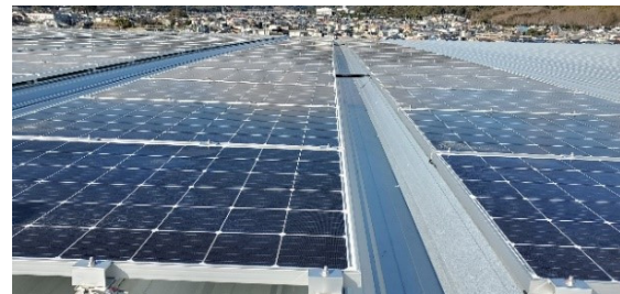
屋上に設置した太陽光発電パネル
