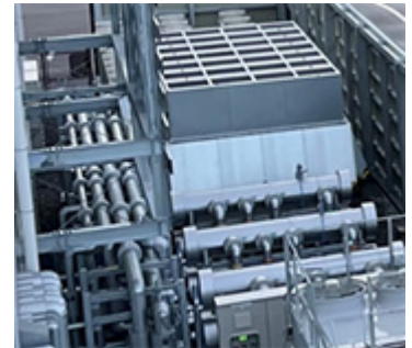
システムを用途別に二つの温度帯に分けることでエネルギー効率を向上しているチラー
